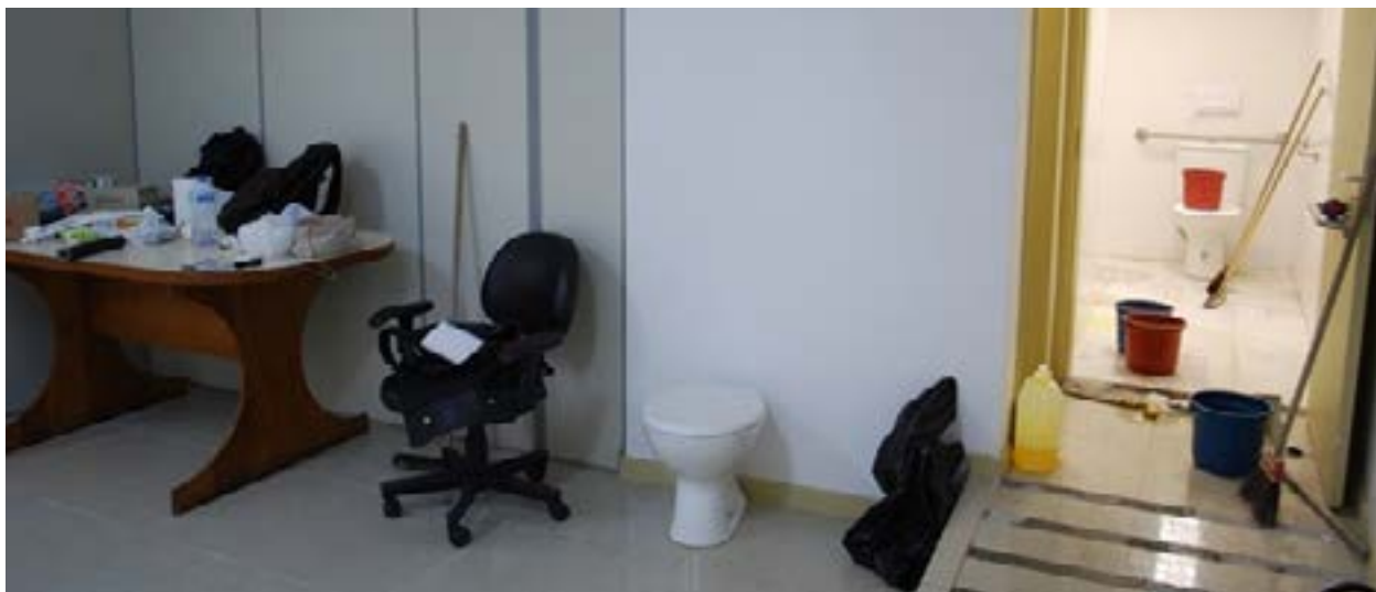
Sanitário no meio da sala desmente afirmações da Chefia de que reforma estava concluída
