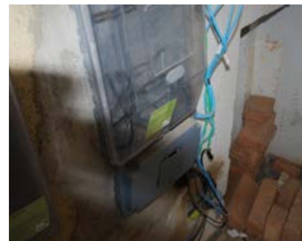
Fios à mostra no quadro de luz da antiga sede da Defensoria Pública em Duas Barras. À época, a comarca foi identificada como a em pior estado no interior.
