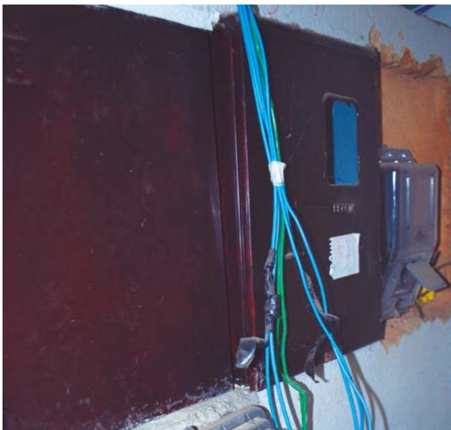
Fios à mostra no quadro de luz na Defensoria em Duas Barras geram insegurança
