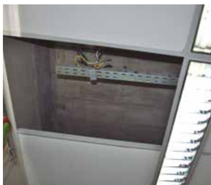
Na sede de Itaguaí não há telhado. Depois de uma chuva, o teto caiu na mesa da Defensora Titular da Vara da Infância.
