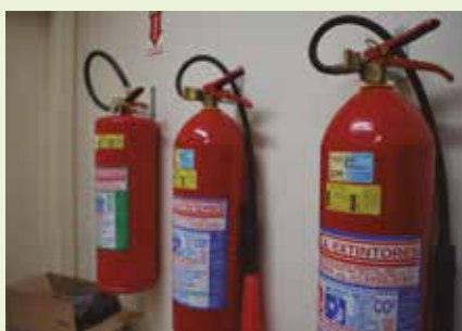
Extintores em Itaguaí estão vencidos há pelo menos dois anos. Apesar dos pedidos feitos pela Defensora titular da Vara da Família, os novos equipamentos de segurança nunca chegaram.
